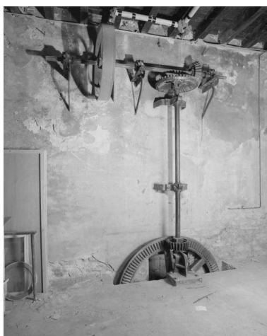
Engrenage situé dans les ateliers, relié à une turbine.
