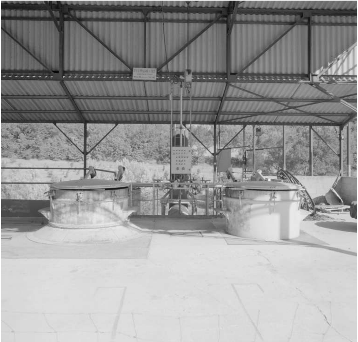
Taulignan. Détail des cuves servant à distiller le lavandin.
