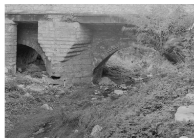
Ancien chemin de Taulignan à Valréas. Pont construit en 1913 sur le canal de la Rialhe : détail de la pile. Phot. Eric Dessert IVR82_20002600917P
