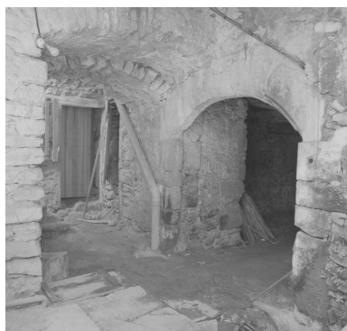
Rue du Coulard, rue de la Poste, maison (AX 100). Caves voûtées en étage de soubassement.
