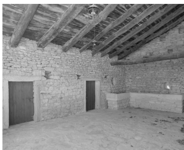
La Garrigue. Intérieur du hangar. Phot. Alain Franchella, Phot. Martial Couderette IVR82_20002600252X
