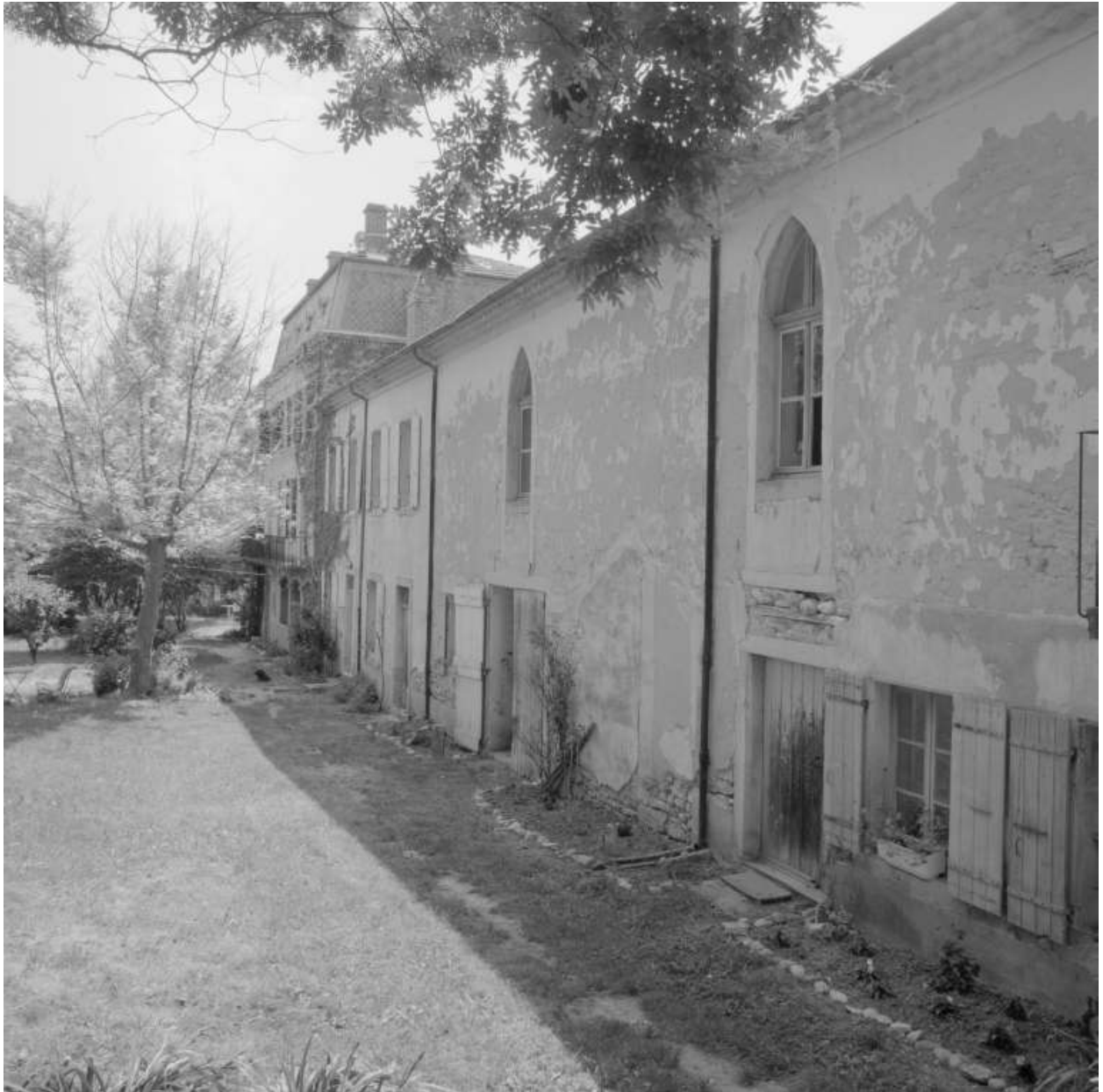
Aile ouest, élévations sur jardin : vue partielle de la chapelle, logement des religieuses et maison de maître.
