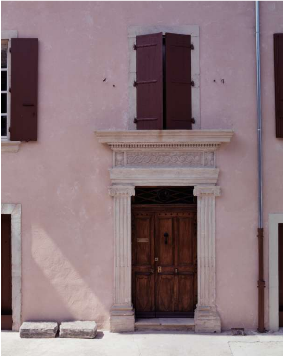
Place de la Résistance, maison de type 4 (AM 198). Baies superposées : porte d'entrée à encadrement de style ionique, au décor soigné.
